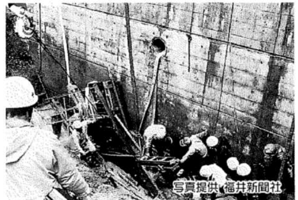
コンクリート生埋め事故
