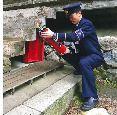
立入査察で消火器の点検をする消防職員
