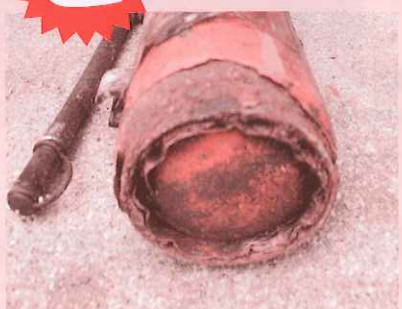
(溶接部とその周辺の腐食)
